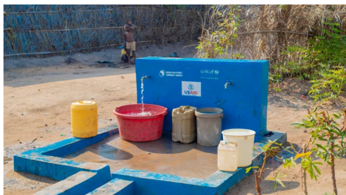
Point d'eau potable à deux robinets construits dans le site des déplacés internes de Mutambara
