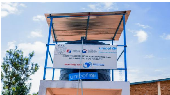
Polytank de 5000L installé
