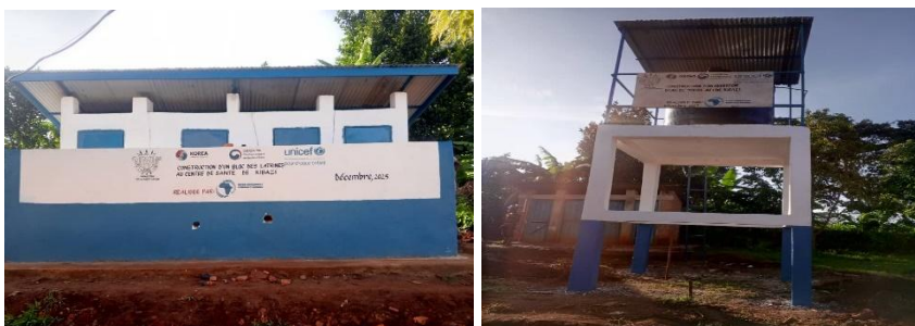
Deux Toilettes et deux douches CDS Kibazi Polytank de 5000L installé
