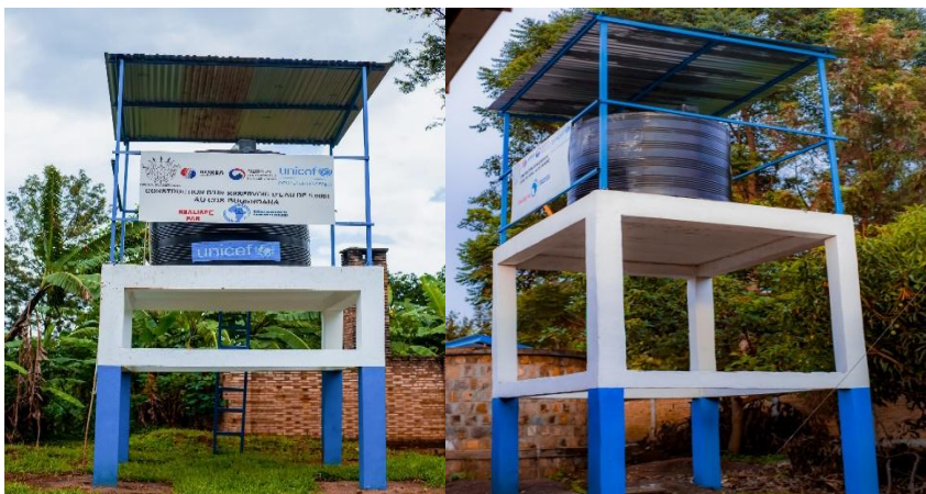
Polytank de 5000L installé
