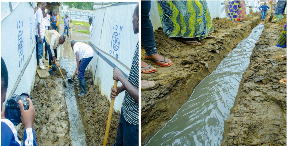
Résultat du traçage de caniveau. Finalement les eaux stagnantes peuvent couler.
